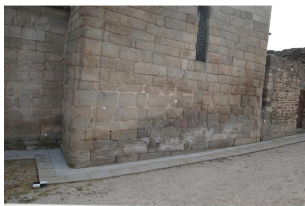
Figura 8: Fachada norte de Santa María de Melque, donde se aprecian patologías de humedad por capilaridad y eflorescencias salinas.
